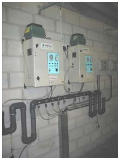
Detalle instalación de ozono ambiental
